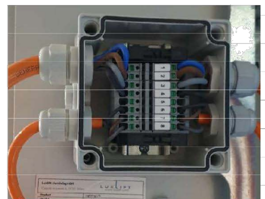
Cableado eléctrico sencillo
